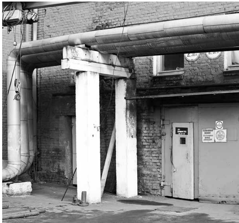
Тепловой пункт в ЛЦ-2
